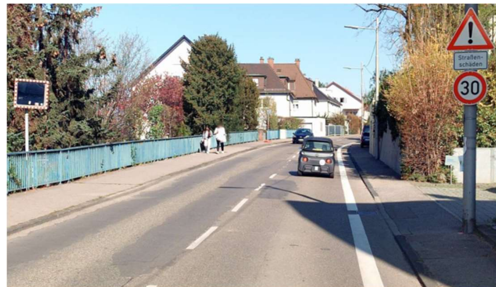
Straßenschäden in der Kappelbergstraße
