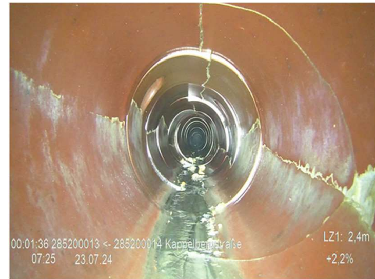
Beschädigter Kanal in der Kappelbergstraße
